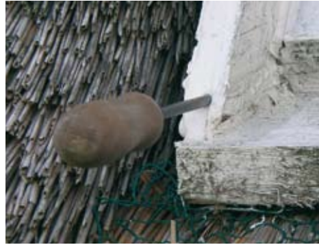
Fehlerhafte Sanierung eines Mühlenfensters mit einer dauerelastischen Dichtungsmasse.
