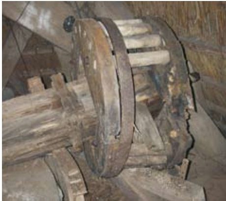
Spill und Korbrad eines Schrotgangs müssen komplett erneuert werden.
