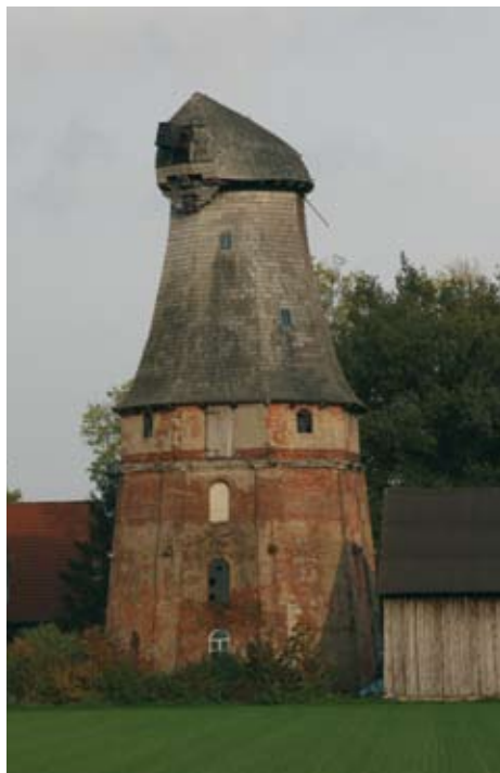
Die Mühle Bensen-Eitzen im aktuellen Zustand. Sie ist unbedingt erhaltungswürdig. Repros und Fotos: F. Butt
