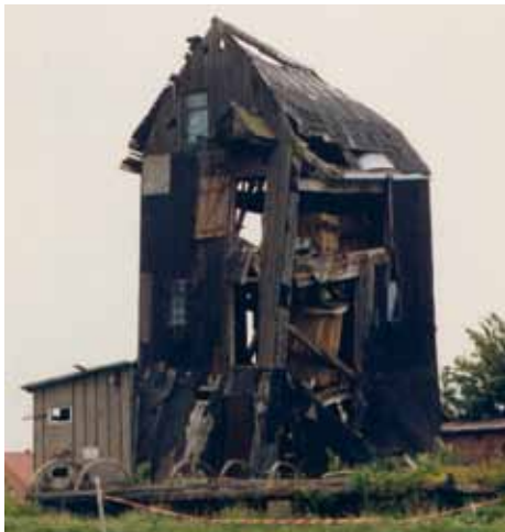
Die Paltockmühle Asel im Zustand des Verfalls, kurz vor Beginn der Restaurierung 1992.
