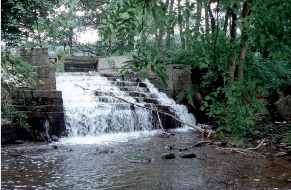
Das historische denkmalgeschützte Kaskadenwehr aus dem Jahr 1714 an der Bückeburger Aue bei Vehlen.
