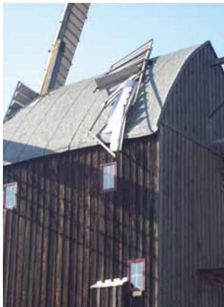
Sturmschaden Orkan Xynthia März 2010.
