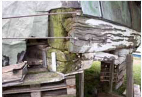
Erhebliche Schäden am Holz.
