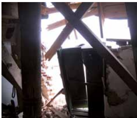
Das Flügelkreuz durchbrach das Mauerwerk.
