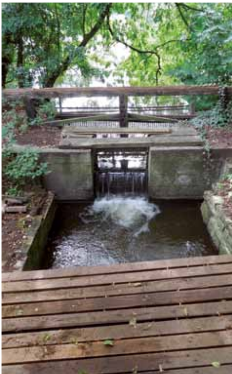
Das Vorgerinne mit provisorischem Steg. Der Rechen verhindert das Einschwemmen von Treibgut.
