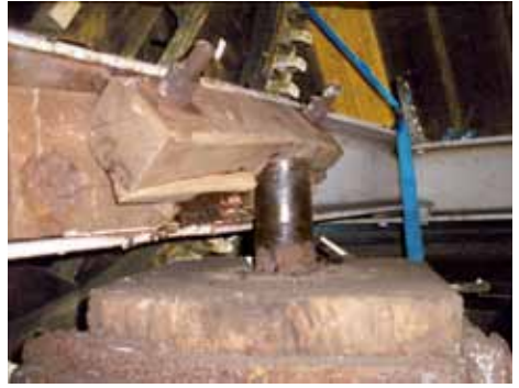
Oberes Königslager, Lagerschalen zerstört.
