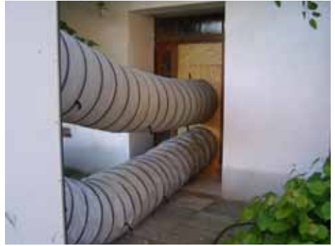
Durch diese Rohre wurde die warme Luft in das Gebäude eingeführt.
