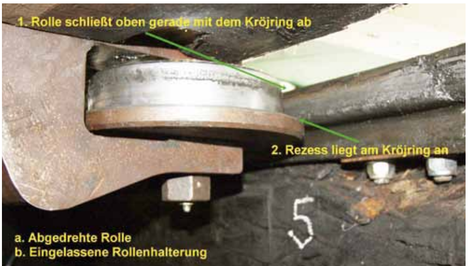
Ordnungsgemäße Gleitrolle unter dem Rösterboden.
