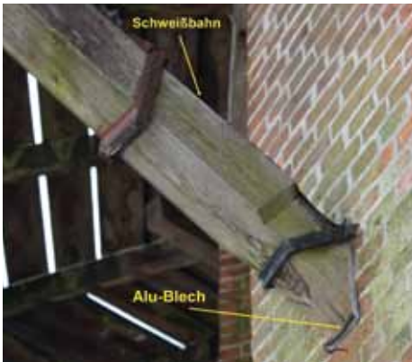
Abdichtung an den Schoren der Galerie.
