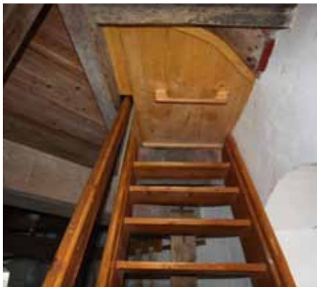
Gesicherter Treppenaufgang mit Lukenabdeckung.
