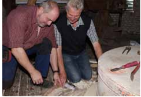
Die von Holzwürmern zerstörte hölzerne Umrandung (Bütte), in der das Mehl aufgefangen wird, wird hier erneuert.
