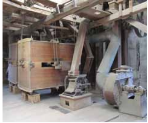
Kreiselpfansichter und Durchlaufwaage im Dachgeschoss.
