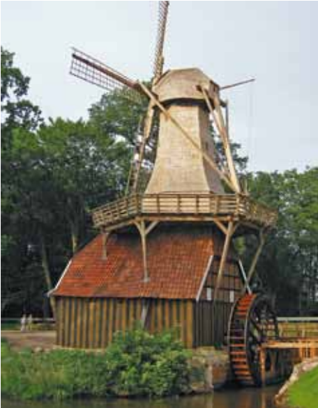
Neu errichtete Galerie in Eichenholz und Verkleidung des Windmühlentapels und der Kappe mit gespaltenen Eichenschindeln und neues Wasserrad.
