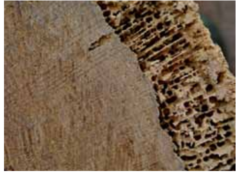
Durchlöcheretes befallenes Holz.
