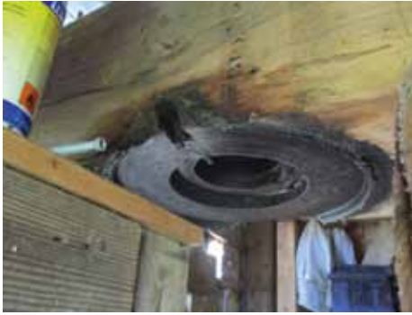
Der alte Hammerbalken wird seitlich aus dem Mühlenkasten gezogen. Blick auf freigelegte Drehlager.
