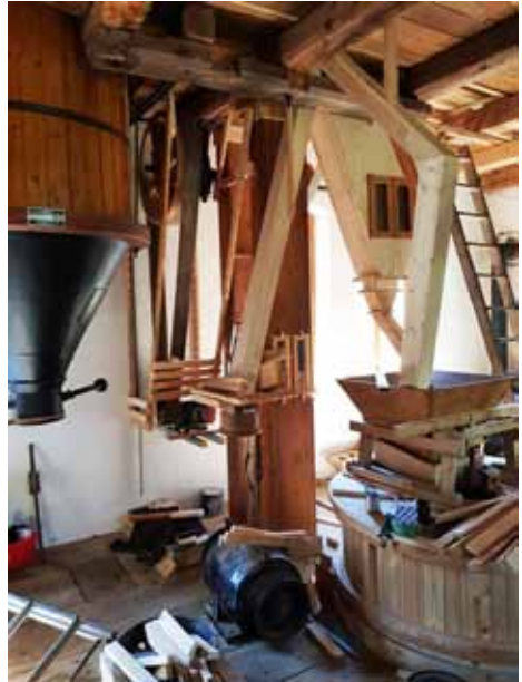
Schmiegenrohre der Backschrotabsackung und der Getreidezulauf zum Mahlgang. Der Motor für Elevator und Sichter dahinter, ebenso Vorbehälter für die Siebübergänge.
