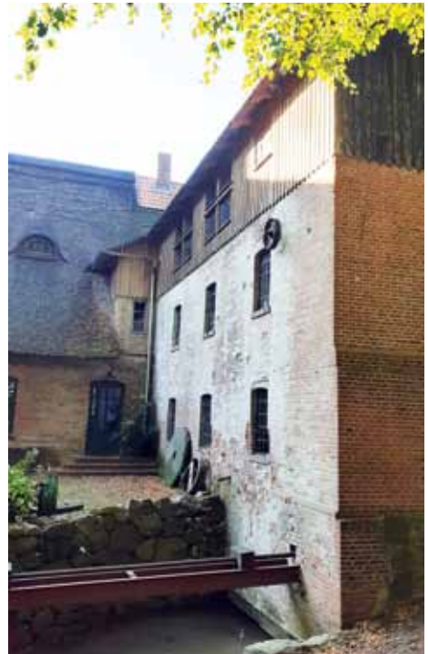
Bild 10: Ansicht heute. Die Bauschäden sind behoben, der Baum ist gefällt, auch die 30 m lange Antriebswelle der Gattersäge ist seit 2018 wiederhergestellt und in Betrieb.
