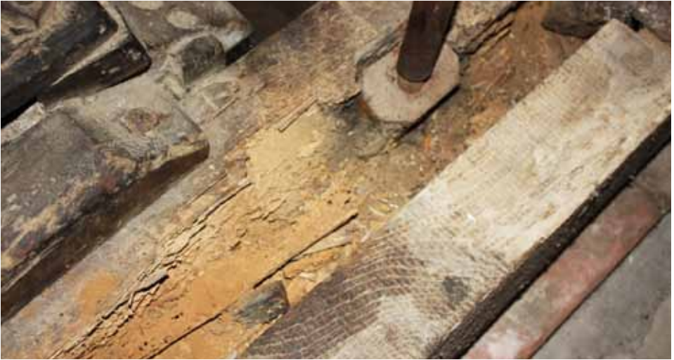
Blick auf zerfressene Balken.
