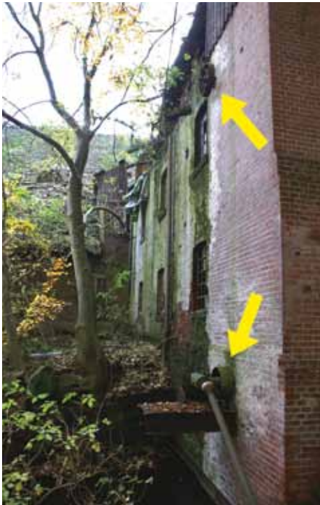
Bild 9: Mühlenrettung im Jahr 2012, der letzte Hafer war längst gequetscht! Riemenscheiben mit Gelenkwelle am Mühlenhaus. Montage auf der Konsole, über die die bereits früher abgebaute Antriebswelle vom Wasserrad zur Gattersäge verlief.
