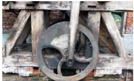
Unterer Gatterrahmen mit Schwungrad und Gatterstelze auf brüchigem Fundament.
