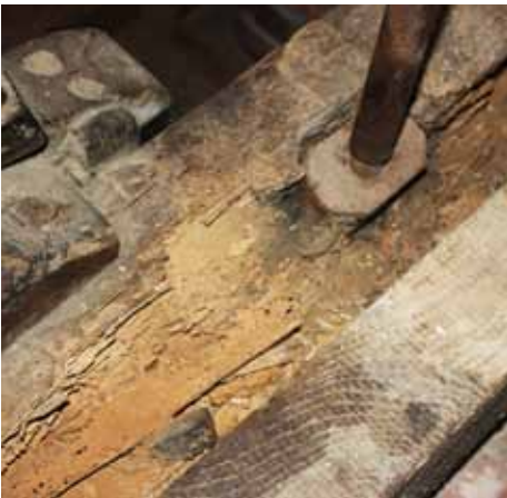
Blick auf zerfressene Balken.
