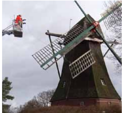
Immer hilfsbereit. Die Feuerwehr sichert den beschädigten Flügel. Foto: NOZ
